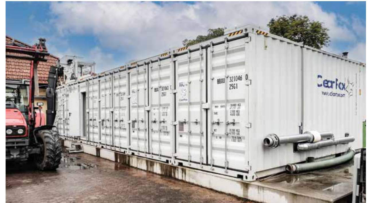
In den Containern verbirgt sich die eigene Abwasser-Kläranlage des Weinguts.
